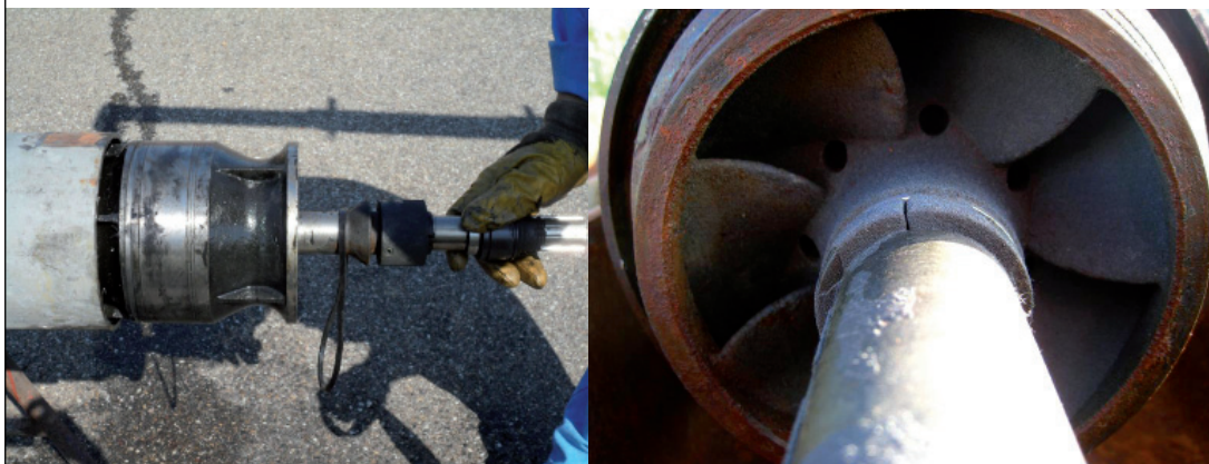
Abb. 52: Ansicht des untersten Saugkorbs (links) und des untersten Impellers aus Hastelloy C-276 (rechts).
