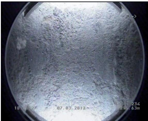
Abb. 40: Bohrung GPK4. In 295 m Tiefe ist die Verrohrung komplett mit einer dünnen Schicht von grauen Ablagerungen bedeckt.
