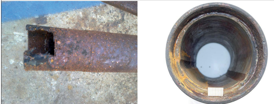
Abb. 46: Spannungskorrosion des Schmierstranges der Pumpe im November 2011 (links) und eines Bronze-lagers im Mai 2012 (rechts).
