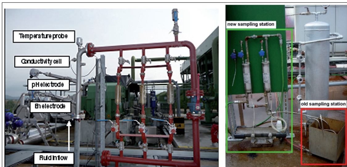
Abb. 19: Niedertemperaturbypass (LTS: Low Temperature Skid) mit Leitfähigkeits-, Eh und pH-Elektroden (links). Festinstallierte Kühleinheiten zur kontrollierten Abkühlung des Thermalwassers von 160 °C (Förderbohrung) bzw. 70 °C (Reinjektionsbohrung) auf die jeweils benötigte Endtemperatur (rechts).
