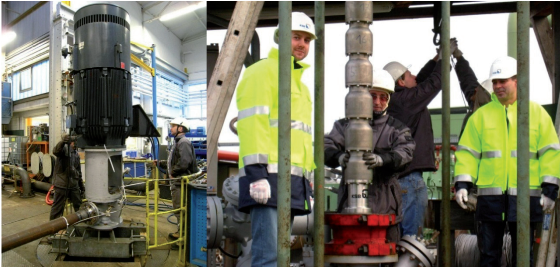
Abb. 50: Die Pumpe beim Test in Hamburg (links) und beim Einbau in die Bohrung GPK2 (rechts).
